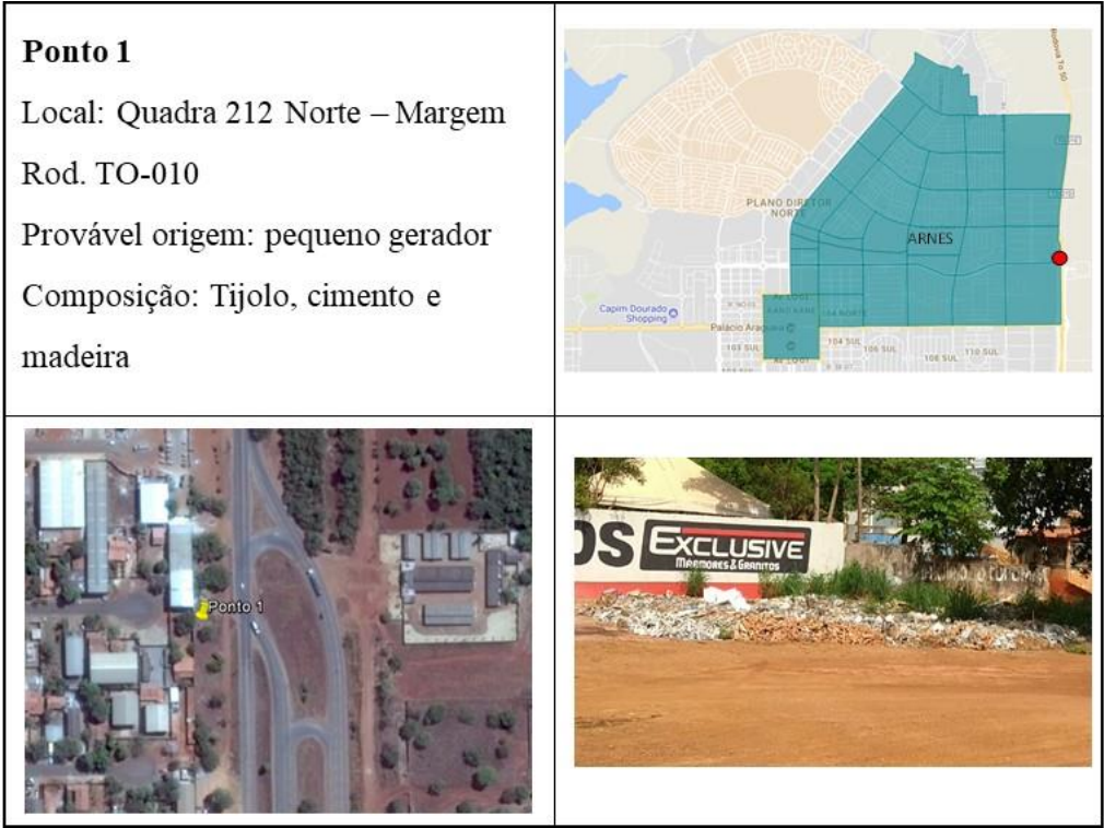
Figura 41: Ponto 1 de lançamento clandestino de RCC na região norte.
