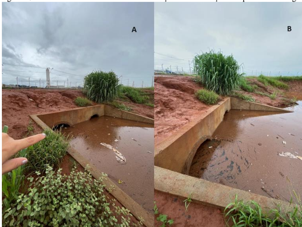
Figura 104 - Ponto de entrada da bacia de infiltração com tubulação completamente afogada
