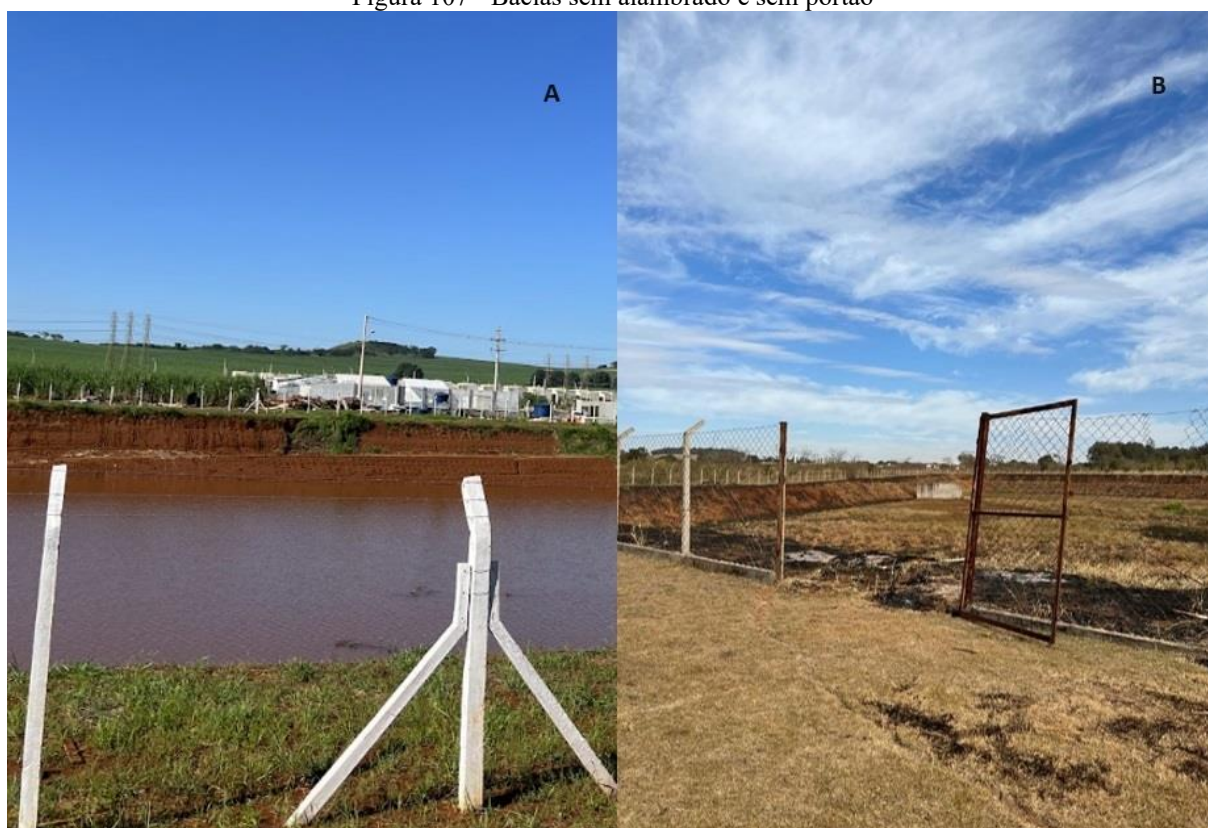
Figura 107 - Bacias sem alambrado e sem portão
