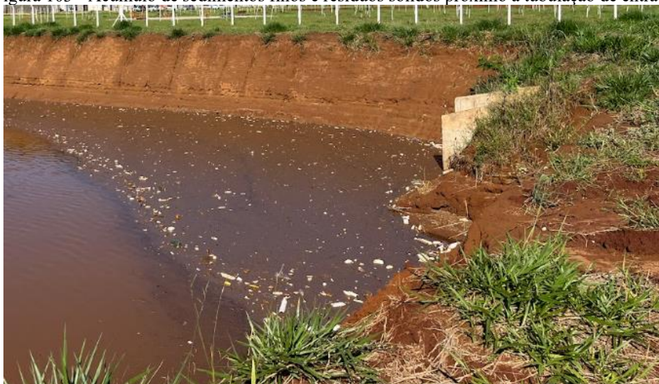
Figura 103 - Acúmulo de sedimentos finos e resíduos sólidos próximo a tubulação de entrada
