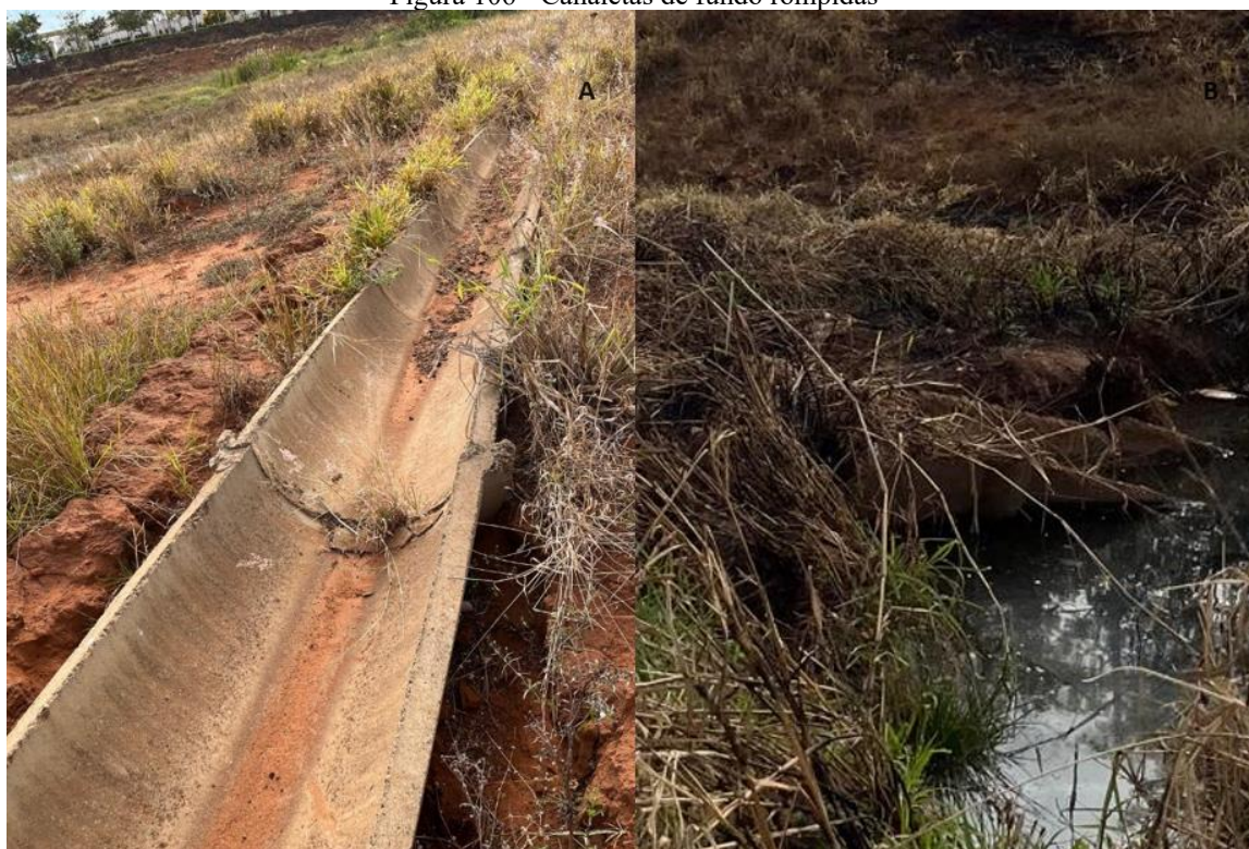
Figura 106 - Canaletas de fundo rompidas
