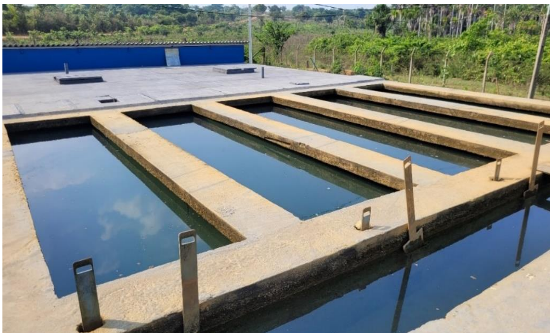
Figura 38 Filtros da ETA
