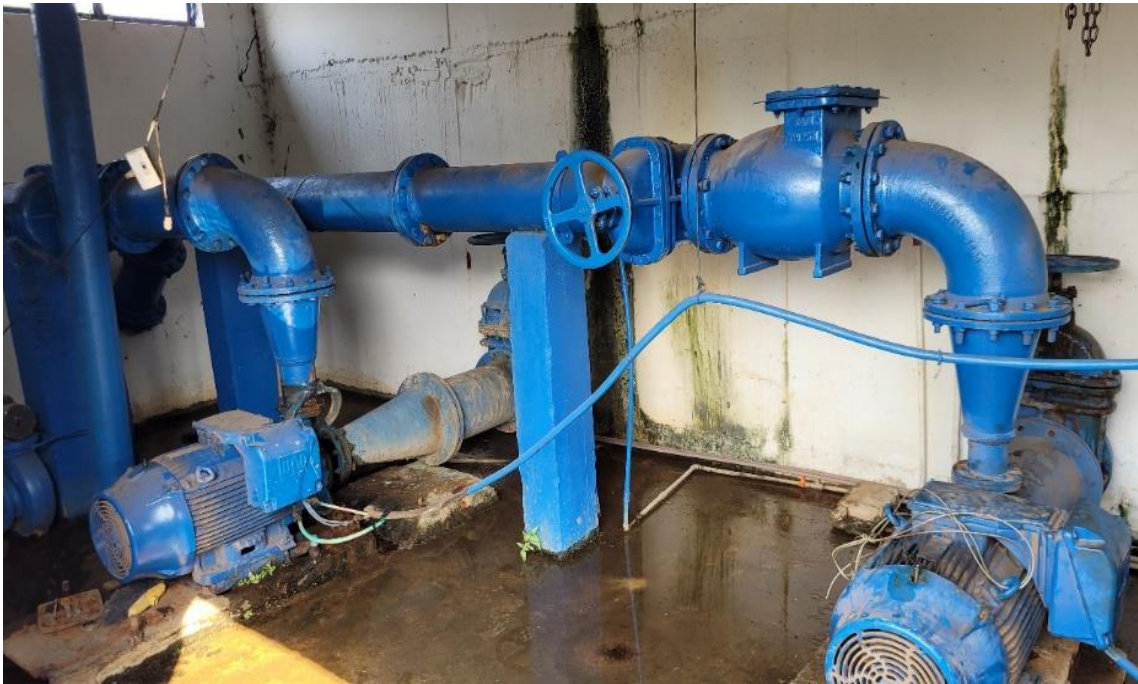
Figura 35 Estação elevatória de água tratada no SAA de Araguatins
