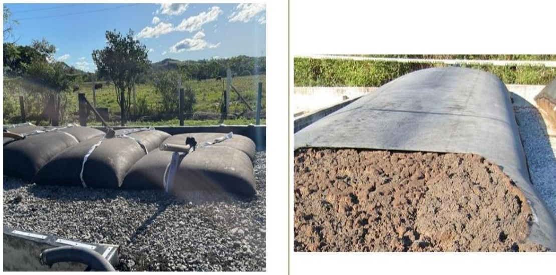
Figura 8 Bag para desaguamento do lodo e lodo desidratado em bag
