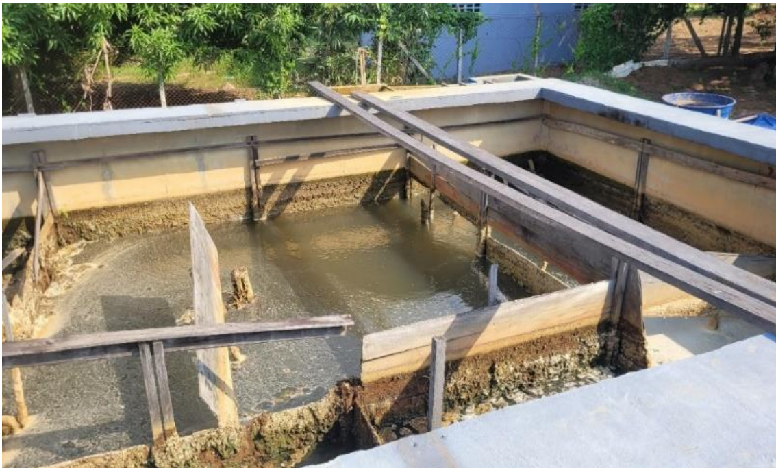
Figura 36 Floculador da ETA
