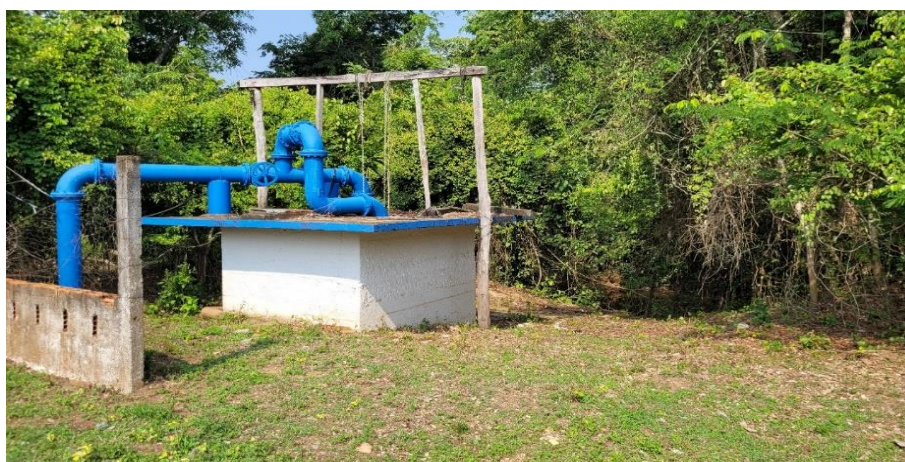
Figura 32 Bomba de sucção da água bruta
