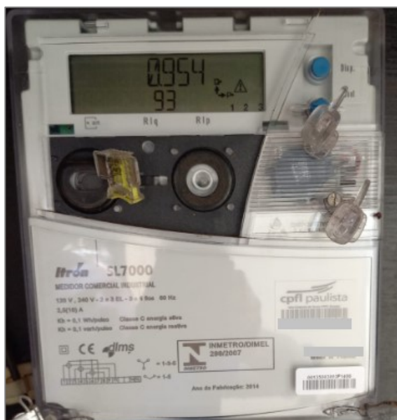
Figura 33 – Medidor de energia da concessionária.
