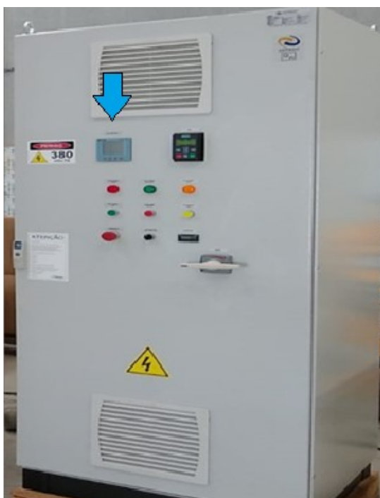
Figura 34 – Multimetedor de grandezas elétricas instalado no CCM.
