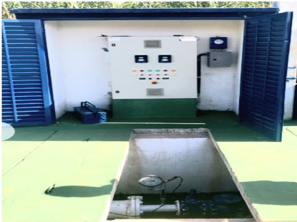
Figura 22 – Booster no sistema de distribuição de água em um dos pontos da cidade.
