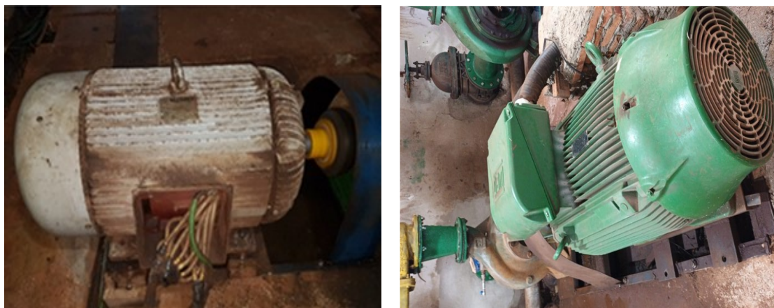
Figura 43 – Motor de baixo rendimento à esquerda e motor novo de alto rendimento à direita instalados em EEAT da Empresa Pública de Saneamento.
