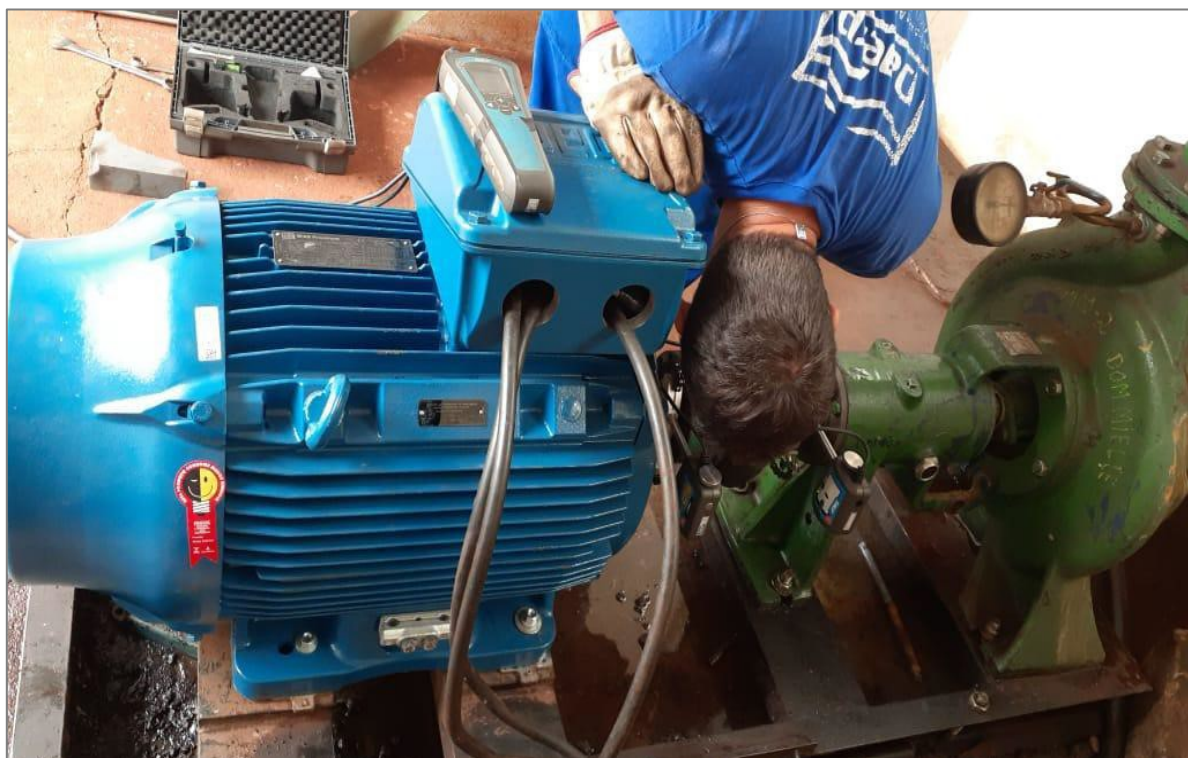
Figura 42 – Instalação do motor de alto rendimento.
