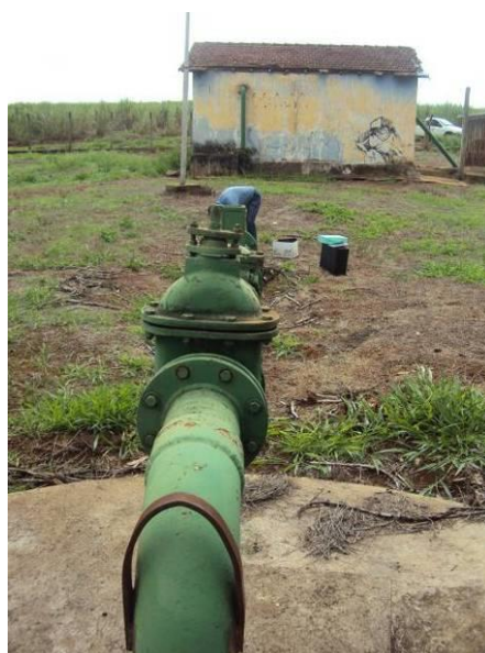
Figura 08. Poço nº04 que abastece o CRD1.
