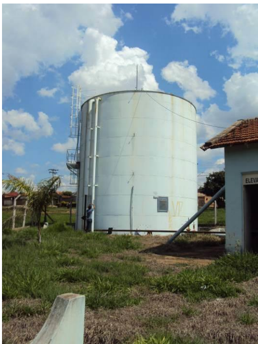
Figura 11. Reservatório existente no EAB01.
