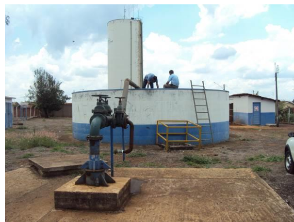
Figura 21. Vista do Poço nº10 que abastece o CRD3.
