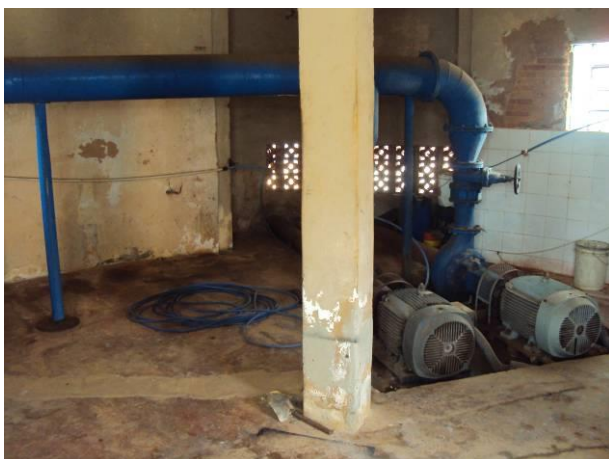
Figura 16. Sistema de recalque existente no CRD1 para abastecer o reservatório elevado.
