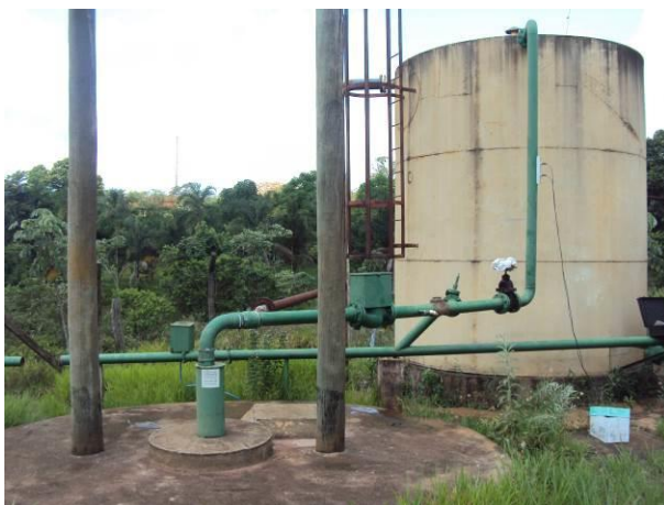
Figura 22. Vista do Poço nº5 e do reservatório de 50m 3 .
