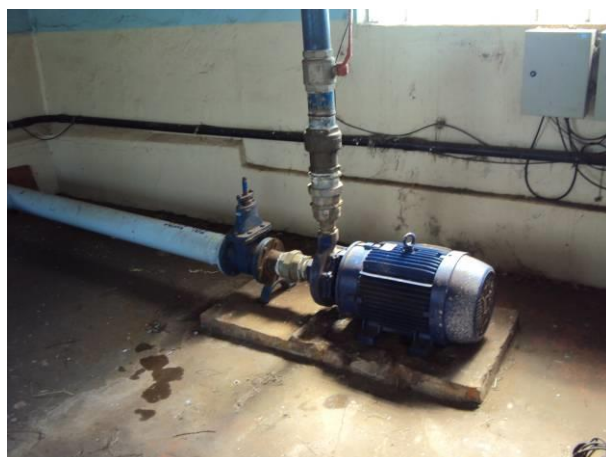
Figura 12. Conjunto motor-bomba existente no EAB01.
