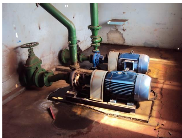
Figura 10. Conjuntos motor-bombas existentes no poço nº04 que recalcam água para o CRD1.
