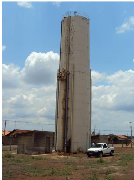
Figura 27. Vista do reservatório existente no CRD6.
