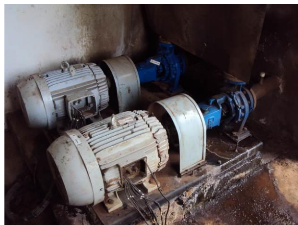
Figura 23. Vista dos conjuntos motor-bombas existentes junto ao Poço nº5.
