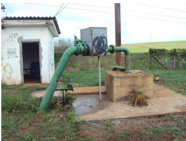
Figura 07. Poço nº07 que abastece o CRD1.
