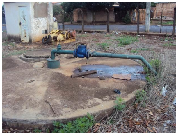
Figura 19. Poço nº03 que abastece o CRD2.
