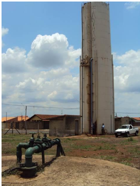
Figura 26. Vista do Poço nº 09 que abastece o CRD6.
