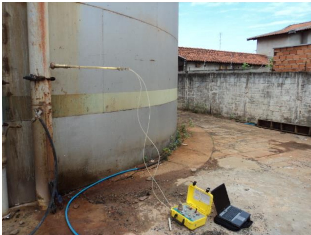
Figura 28. Monitoramento de vazão na EP 02.
