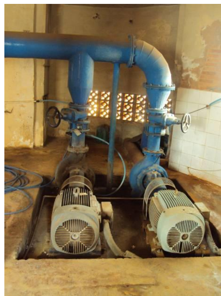
Figura 17. Conjuntos motor-bombas existentes no CRD1 para abastecer o reservatório elevado.
