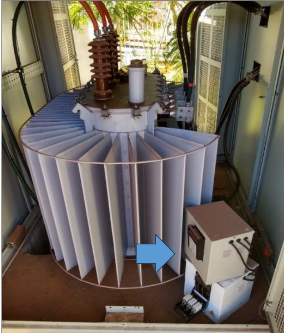
Figura 45 – Bancos de capacitores trifásicos instalados no secundário do transformador.
