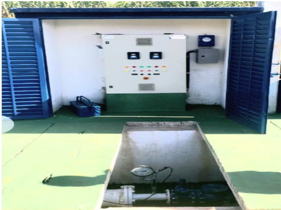
Figura 22 – Booster no sistema de distribuição de água em um dos pontos da cidade.
