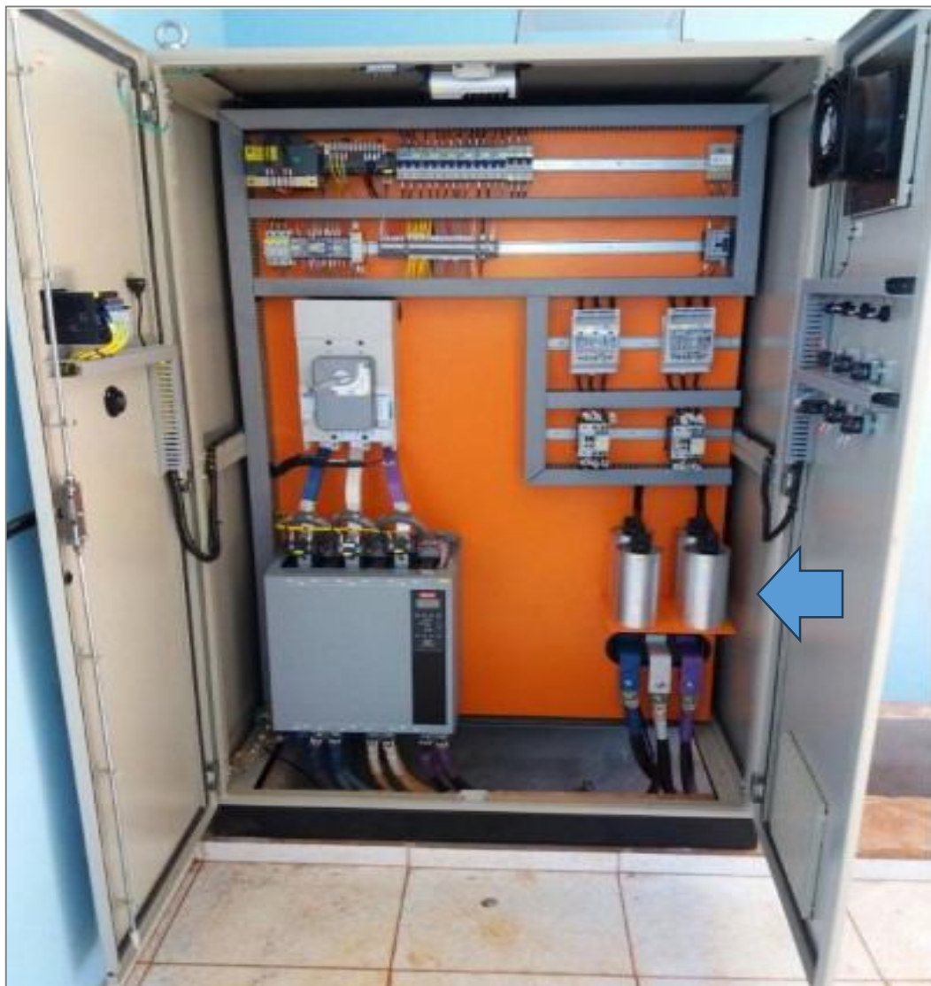
Figura 44 – Banco de capacitor trifásico instalado dentro do CCM.
