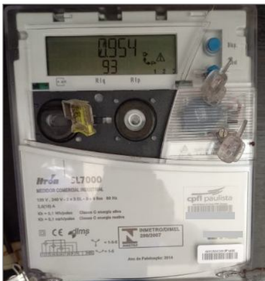
Figura 33 – Medidor de energia da concessionária.
