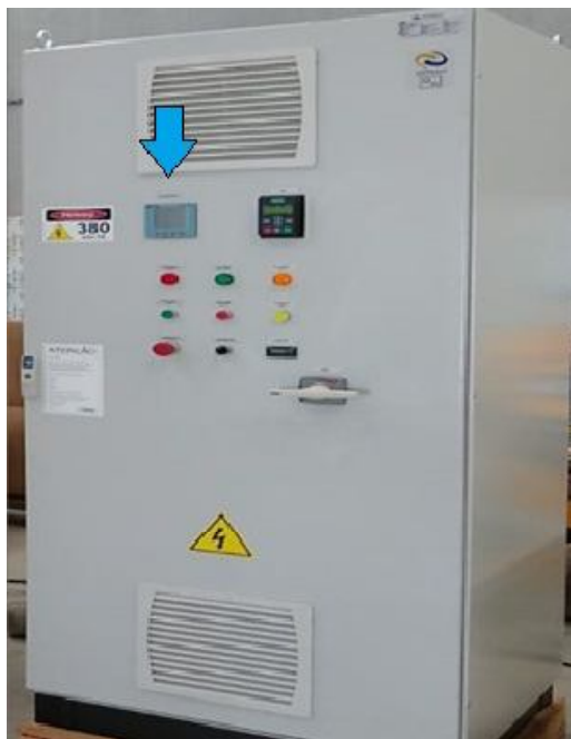
Figura 34 – Multimedidor de grandezas elétricas instalado no CCM.
