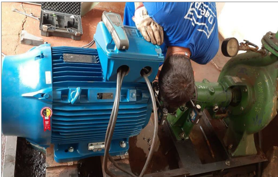
Figura 42 – Instalação do motor de alto rendimento.
