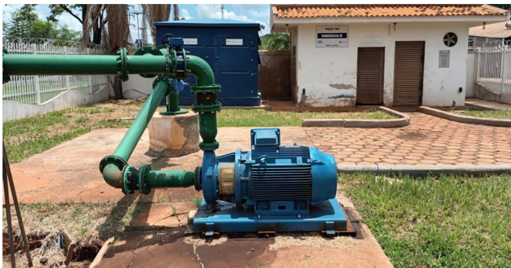
Figura 23 – Booster instalado em um Poço da Empresa Pública de Saneamento.
