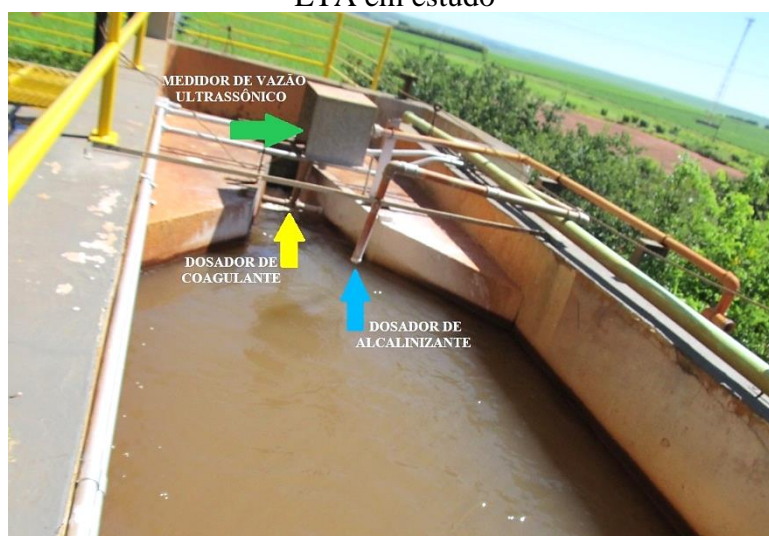
Figura 22. Misturador e medidor de vazão tipo Calha Parshall, com destaque do medidor de vazão ultrassônico instalado e com indicação dos dosadores de coagulante e alcalinizante na ETA em estudo
