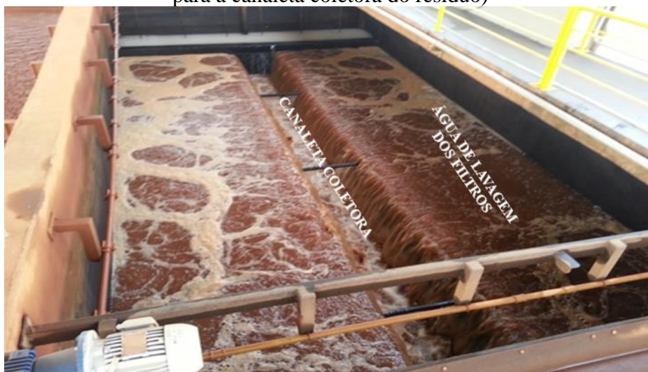
Figura 28. Câmara de floto-filtração (destaque para a água de lavagem dos filtros/Resíduo e para a canaleta coletora do resíduo)
