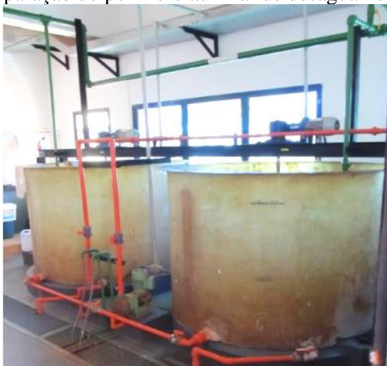
Figura 30. Tanque de preparação do polímero auxiliar de desaguamento do lodo de ETA
