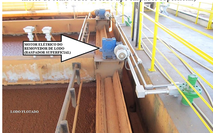
Figura 24. Vista da câmara de floto-filtração (destaque para o lodo flotado/Resíduo e para o motor do removedor de lodo tipo raspador superficial)
