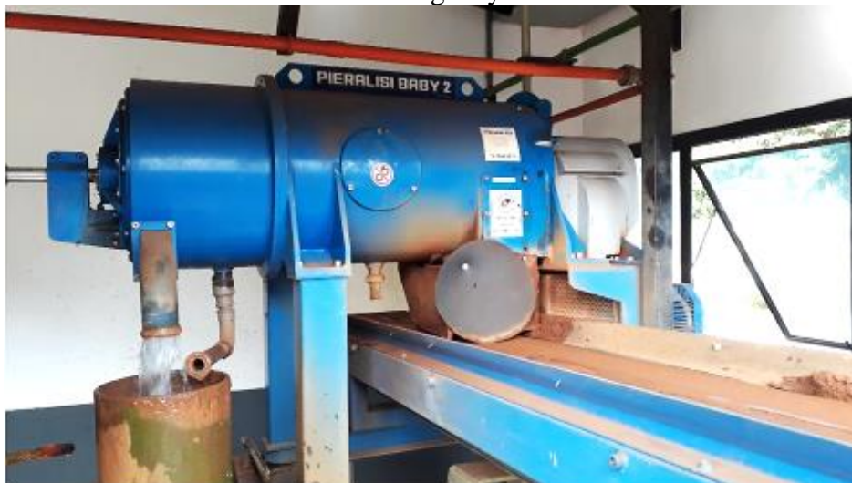
Figura 29. Vista frontal da centrífuga instalada na ETA da Concessionária Águas de Madaguahy
