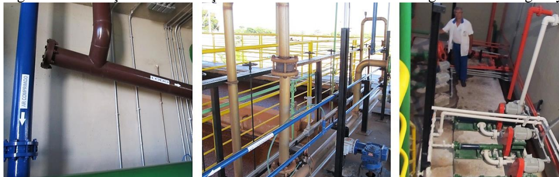
Figura 26. Condições das tubulações da ETA da Concessionária Águas de Mandaguahy
