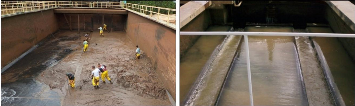
Figura 1: Fotos de RETAs. A esquerda limpeza manual de um decantador; a direita descarte da água de lavagem de filtro
