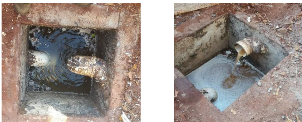
Figura 12: Caixa de passagem
