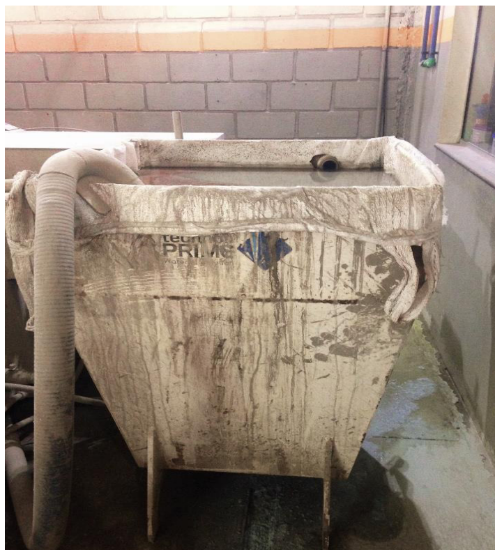
Figura 23 - Tanque de Abrasivo usado 6
