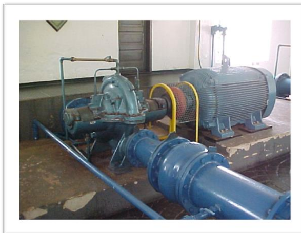
Figura 5: Conjunto moto bomba de recalque da captação Cruzes, DAAE Araraquara
