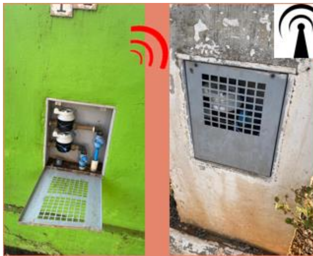
Figura 26: Imagem de instalação do Hidrômetro em caixa dupla no Distrito de Bueno de Andrada
