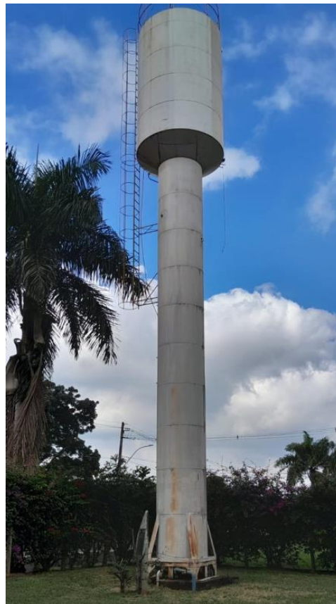
Figura 32: Imagem do reservatório metálico de 30 m3 tipo taça, coluna vazia
