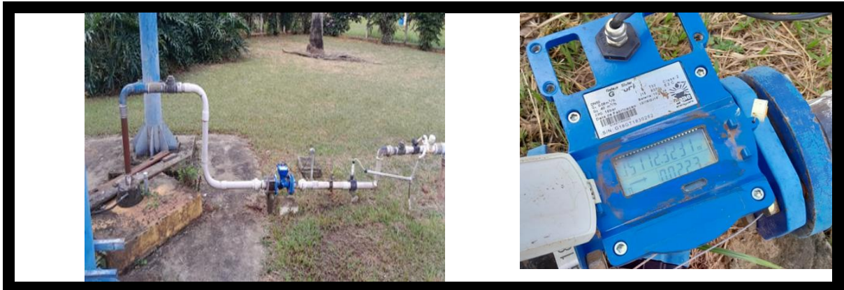
Figura 31: Imagem do poço e cavalete com detalhe do macro medidor
