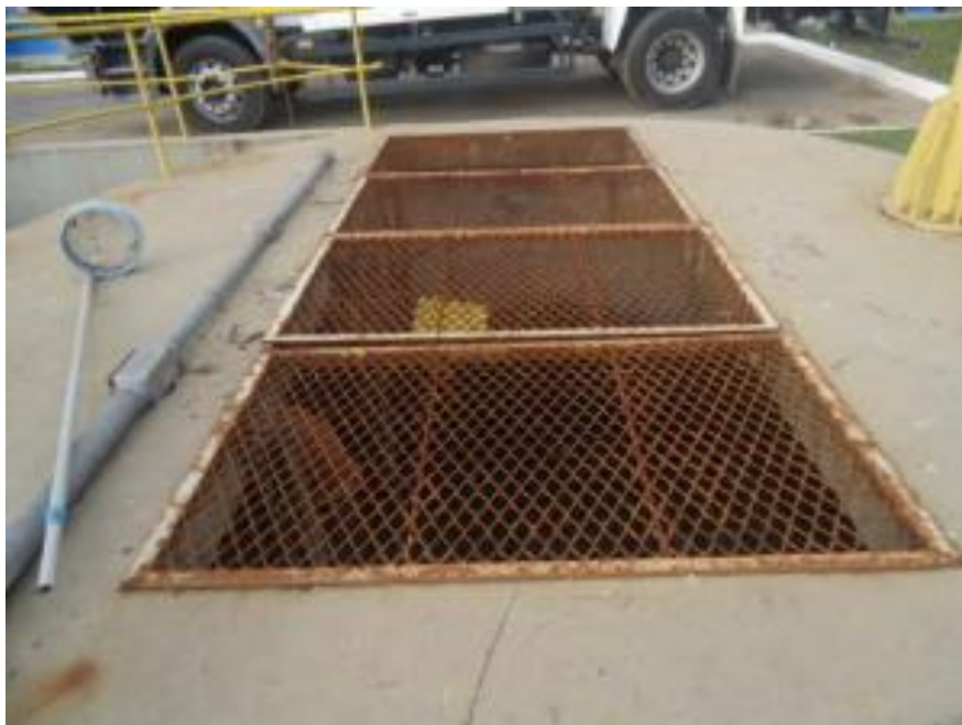
Figura 18. Grades metálicas antigas usadas no tratamento preliminar da ETE Salto do Guimarães.
