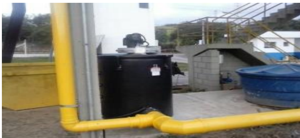
Figura 29. Vista do filtro de carvão ativado.
