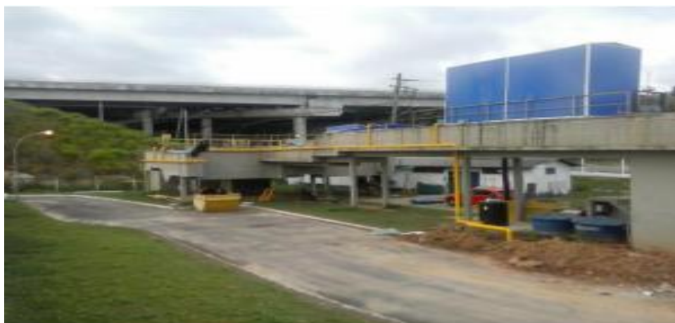
Figura 28. Implantação dos tubos de sucção dos gases.
