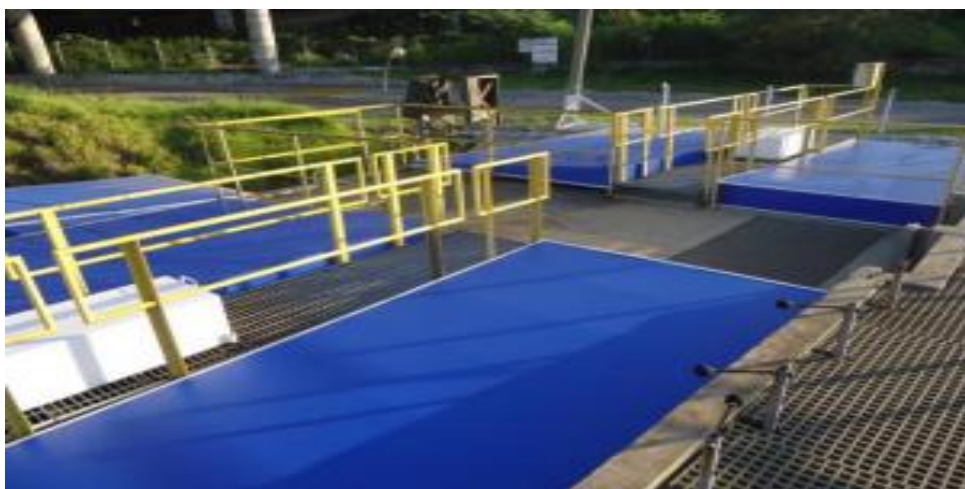
Figura 27. Sistema de cobertura do tratamento preliminar da ETE Salto do Guimarães.
