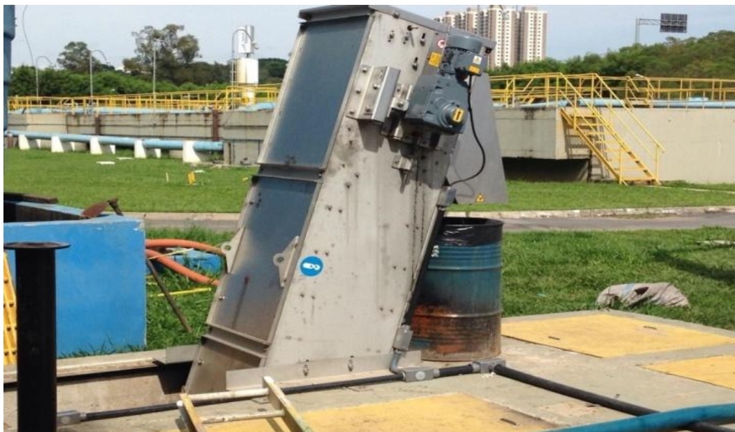
Figura 10. Grade mecanizada no tratamento preliminar da ETE Salto do Guimarães.
