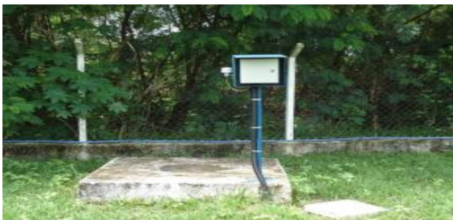
Figura 36. Painel com fotocélula para acionamento de iluminação.
