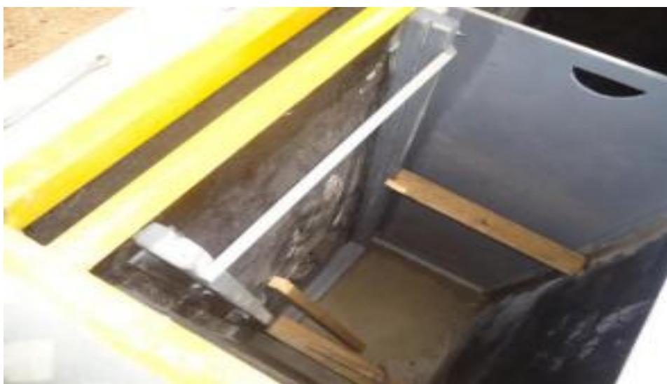
Figura 21. Vista da caixa das comportas e do tanque de contato da ETE Salto do Guimarães.
