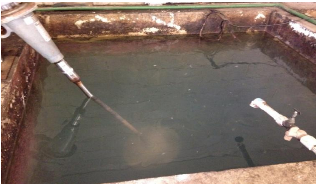
Figura 12. Tanque de dosagem de polímero usado na desidratação do lodo no final do tratamento da ETE Salto do Guimarães.
