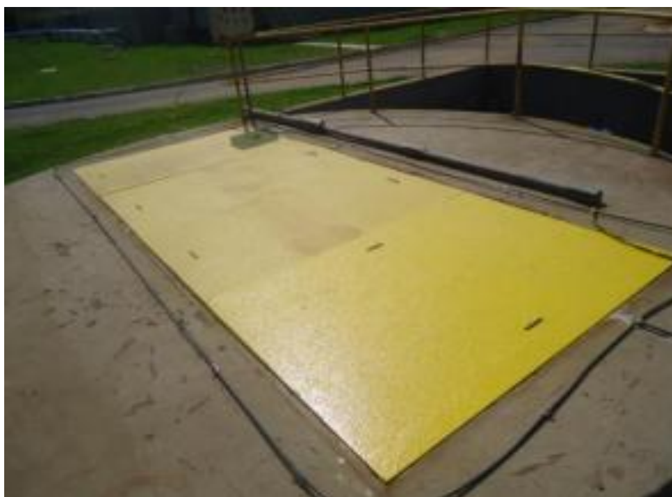
Figura 19. Novas grades em PRFV usadas no tratamento preliminar da ETE Salto do Guimarães.
