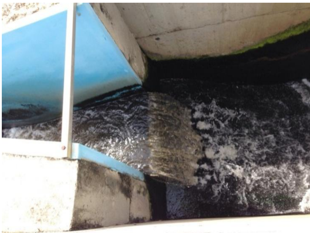
Figura 17. Calha Parshall na saída do tratamento da ETE Salto do Guimarães.
