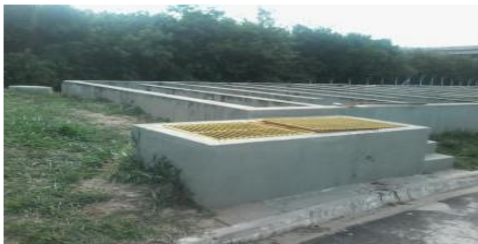
Figura 20. Vista da caixa das compotas e do tanque de contato no final do tratamento da ETE Salto do Guimarães.
