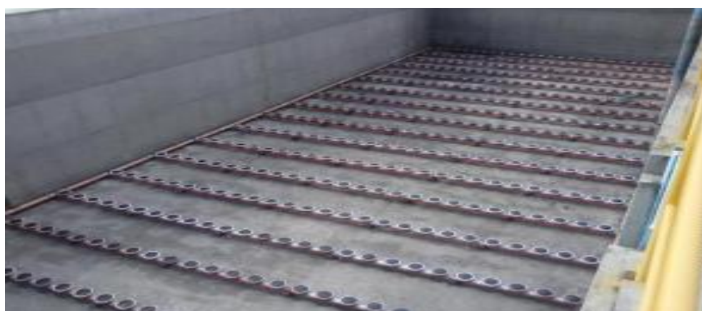
Figura 31. Malha difusora recuperada do tanque (RBSA) da ETE Salto do Guimarães.
