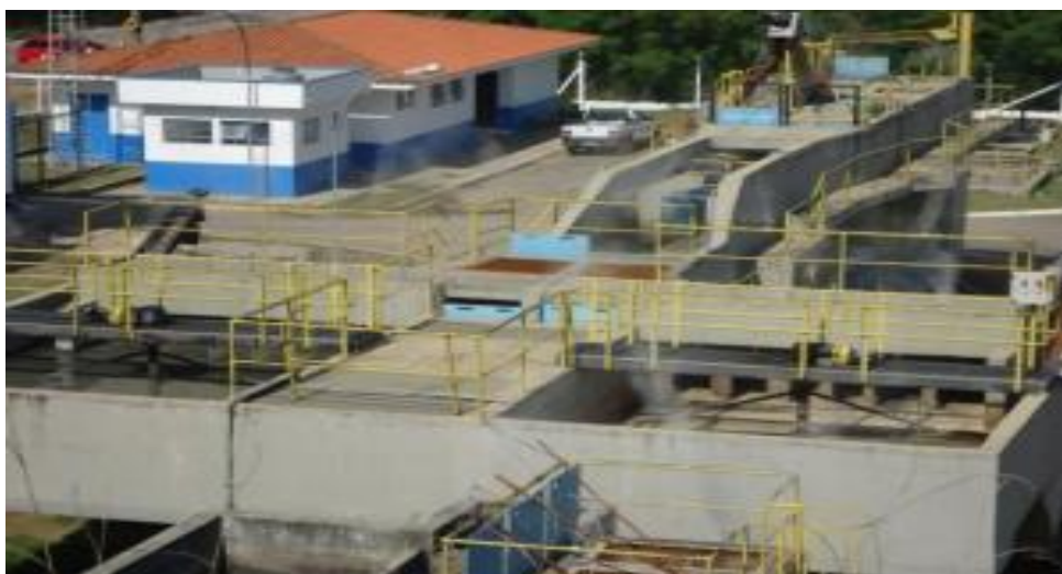
Figura 26. Tratamento preliminar sem cobertura da ETE Salto do Guimarães.
