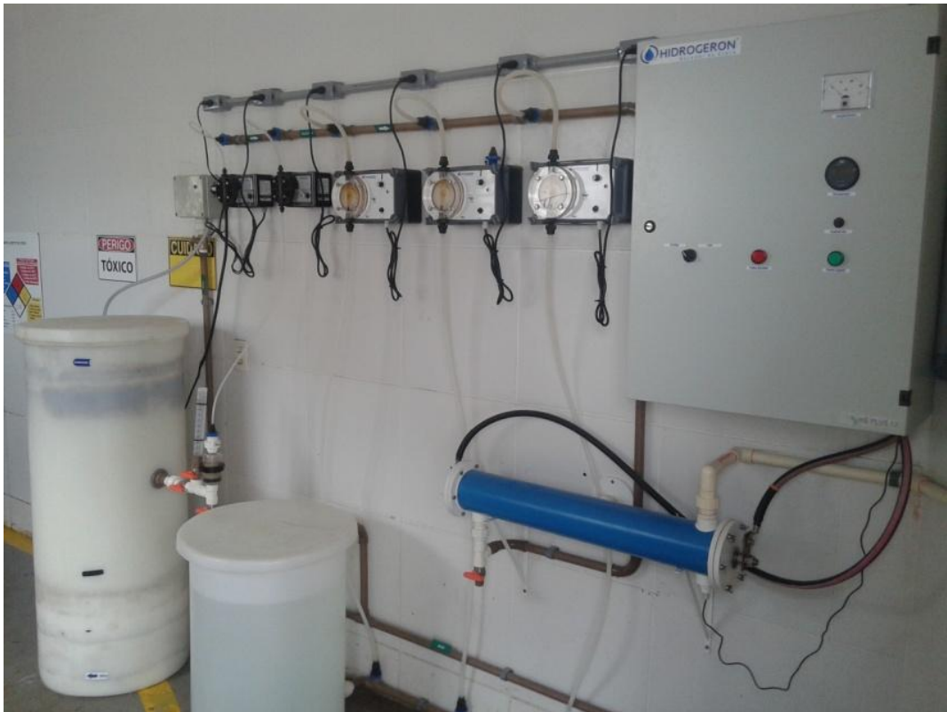
Figura 45. Gerador de Cloro.
