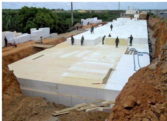
Figura 37. Exemplo do uso dos blocos de EPS no aterro de um viaduto em Jundiaí
