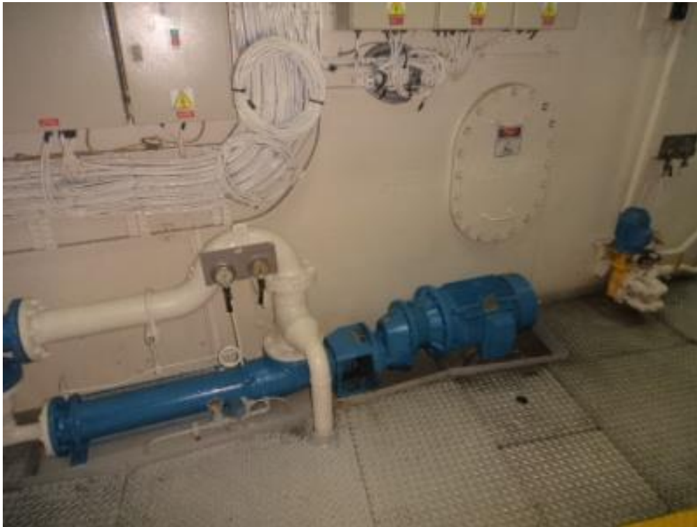
Figura 30: Tanque de armazenamento e bomba de descarga no setor de praça de máquinas em uma unidade SESV
