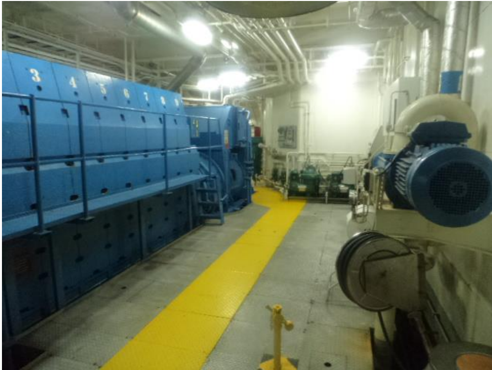
Figura 20: Setor da praça de máquinas em uma unidade SESV
