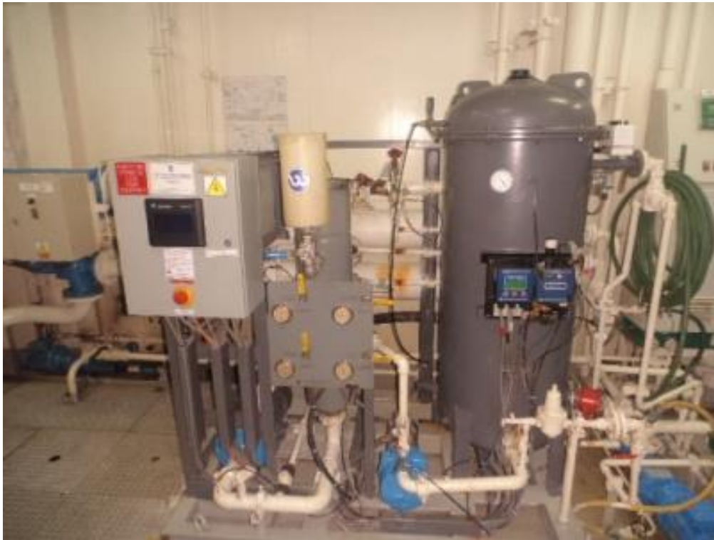
Figura 27: Separador de água e óleo no setor de praça de máquinas em uma Unidade SESV
