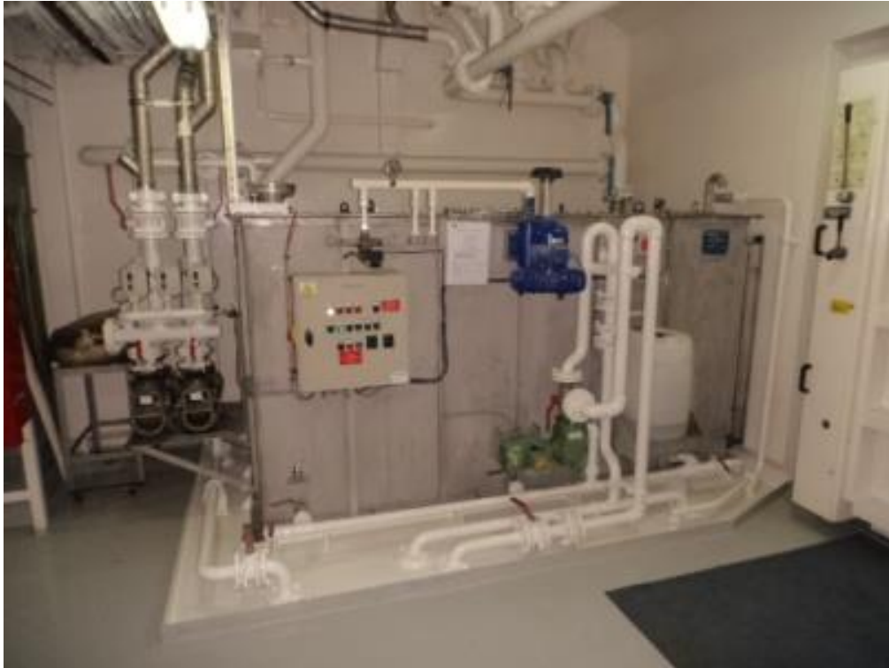
Figura 29: Sistema de tratamento de efluentes pelo princípio biológico no setor de praça de máquinas em uma unidade SESV
