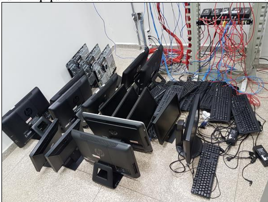
Figura 15 - Equipamentos eletroeletrônicos inservíveis na sala de Data Center
