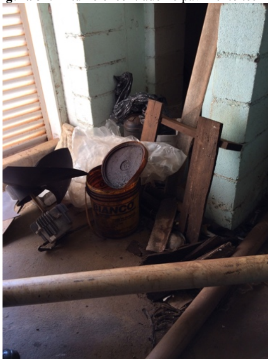
Figura 34: Entulho encontrado no pavimento técnico
