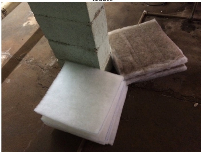
Figura 51: Filtro limpo em contato direto com piso sujo e filtros usados
