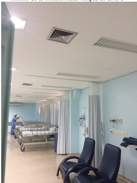
Figura 26: Sala de recuperação com grelhas de retorno do ar condicionado limpas do EAS 3
