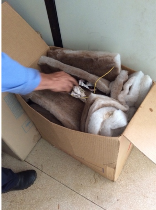
Figura 53: Descarte inadequado dos filtros usados
