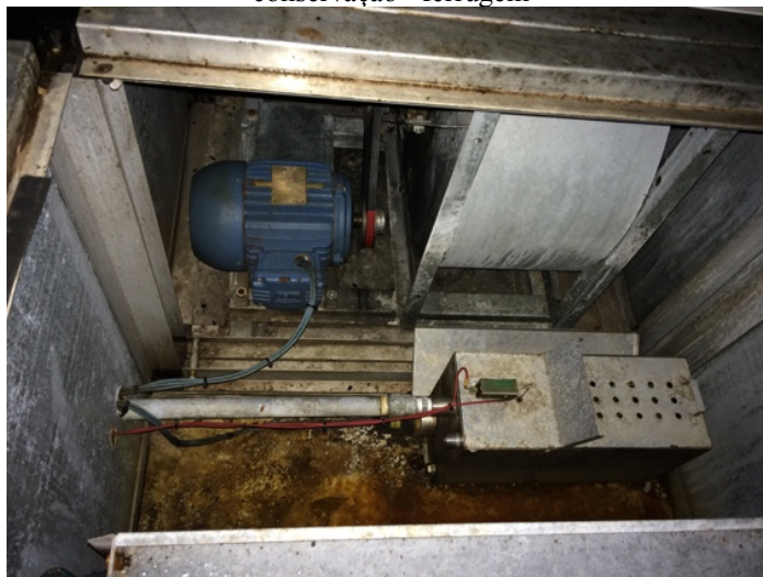
Figura 52: Condições físicas das máquinas em mau estado de conservação - ferrugem
