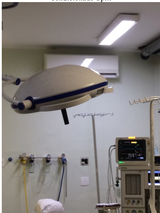
Figura 24: Sala de cirurgia do EAS 2 com ar condicionado Split
