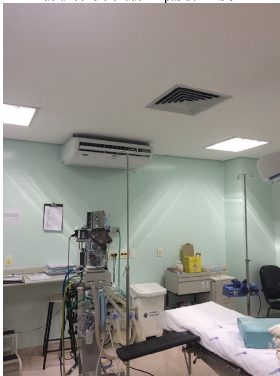
Figura 27: Sala de cirurgia com grelhas de retorno do ar condicionado limpas do EAS 3
