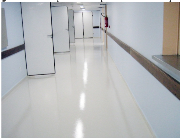
Figura 84: Piso em porcelanato líquido em ambiente hospitalar
