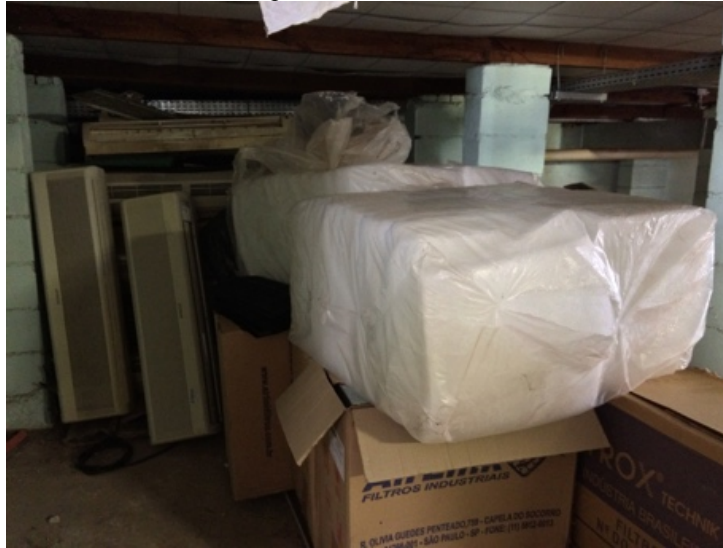
Figura 35: Filtros novos armazenados em meio a sujidades no pavimento técnico
