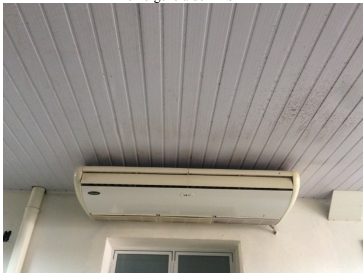
Figura 23: Ar condicionado Split High Wall na sala de emergência do EAS 2
