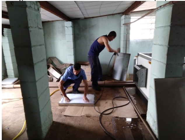
Figura 44: Falta de uso de EPI - vestuário impróprio
