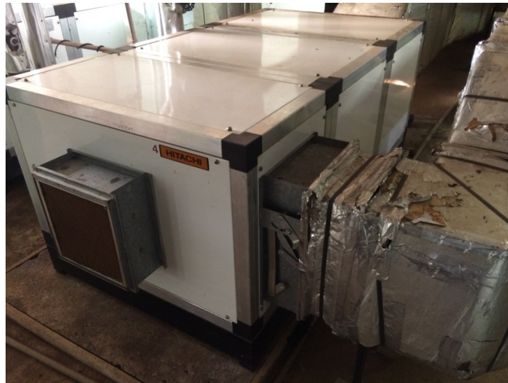
Figura 37: Uma das 4 máquinas do sistema de ar condicionado central do EAS 3
