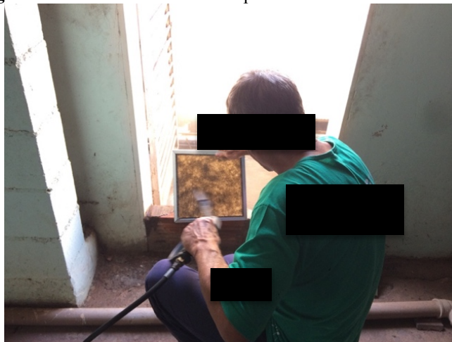
Figura 48: Filtro G1 sendo lavado pelo funcionário da manutenção
