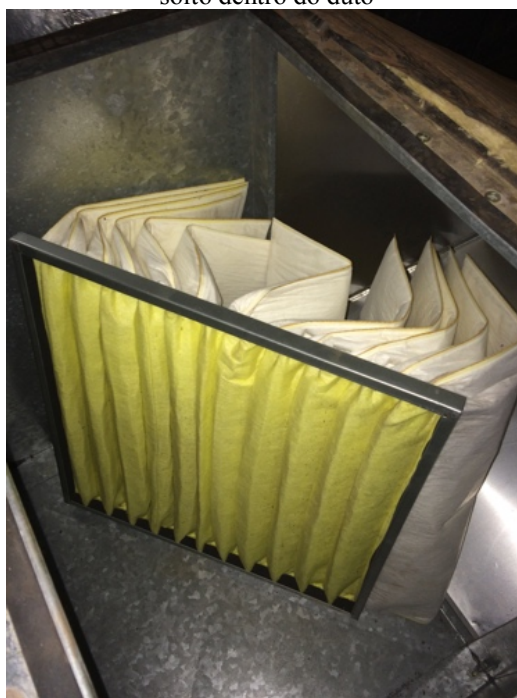
Figura 43: Filtro bolsa tipo F8 da máquina 3, solto dentro do duto
