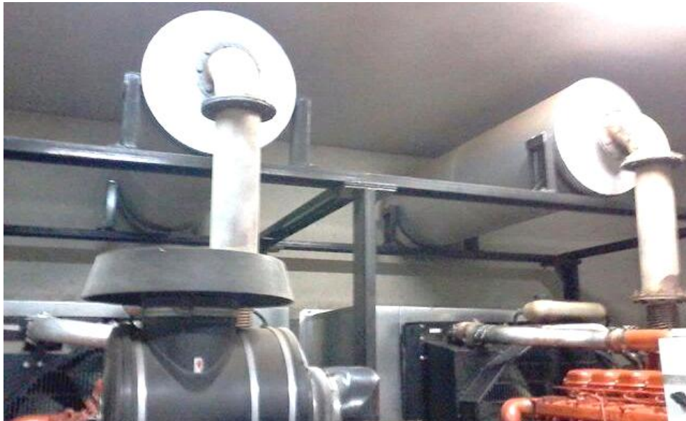
Figura 10 – Foto de silenciadores instalados nas saídas dos gases de escape de GGED da fabricante de grupos geradores Stemac.
