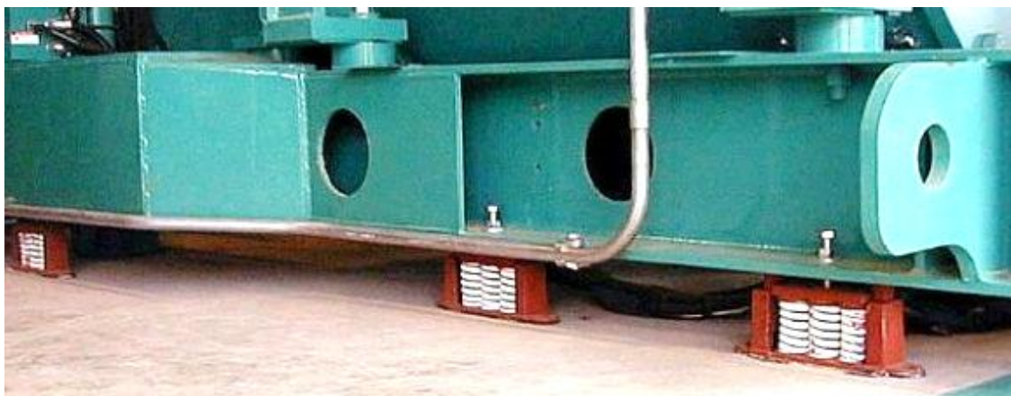
Figura 11 – Foto de isoladores de vibração instalados entre a estrutura metálica do GGED e a base de concreto.
