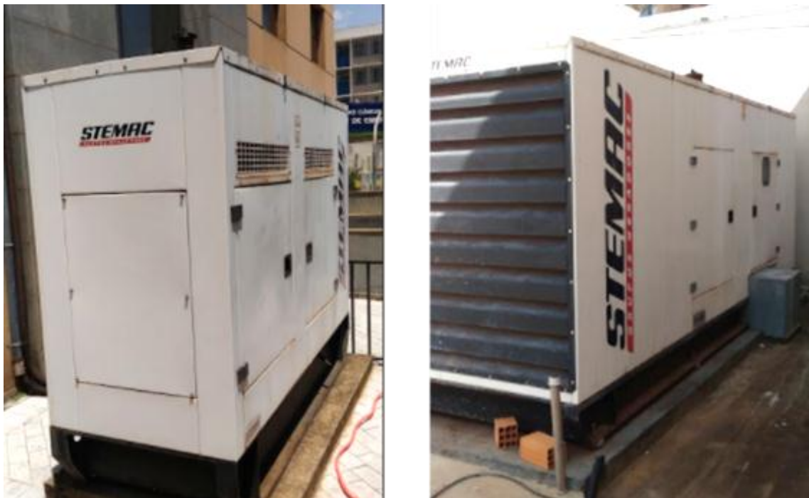
Figura 44 – Fotos de GGED investigados que possuem saídas dos gases de escape posicionadas com alturas de até 3 metros e em locais com circulação de pessoas ou próximo a janelas.
