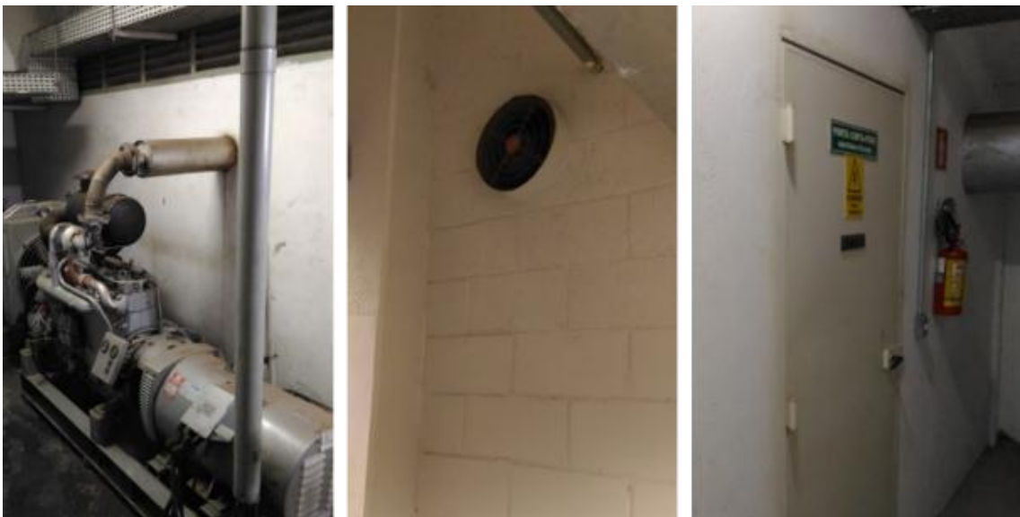
Figura 47 – Fotos de GGED investigados com ventilação do tipo natural (à esquerda), forçada (ao centro) e sem ventilação (à direita), respectivamente.
