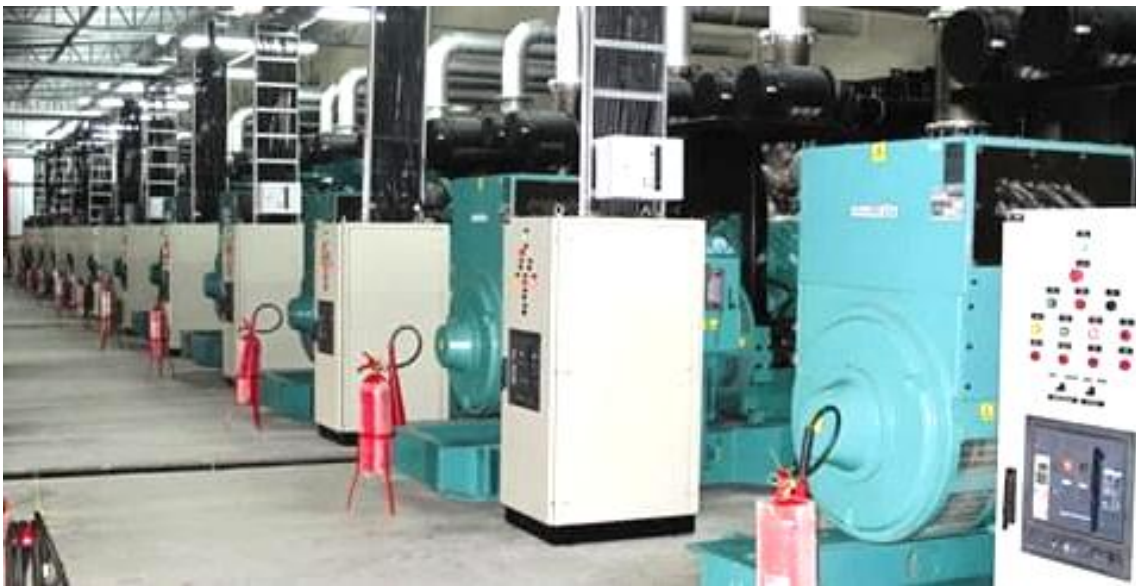
Figura 12 – Foto de extintores posicionados próximos aos GGED.
