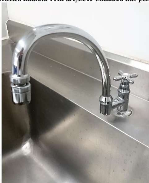
Figura 29: Torneira manual com arejador utilizada nas pias da edificação.
