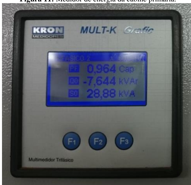
Figura 11: Medidor de energia da cabine primária.
