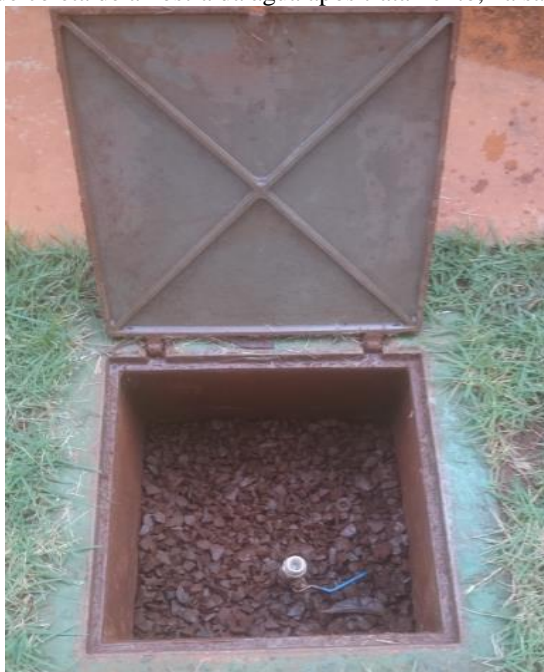
Figura 8: Local de coleta de amostra da água após tratamento, na saída do reservatório
