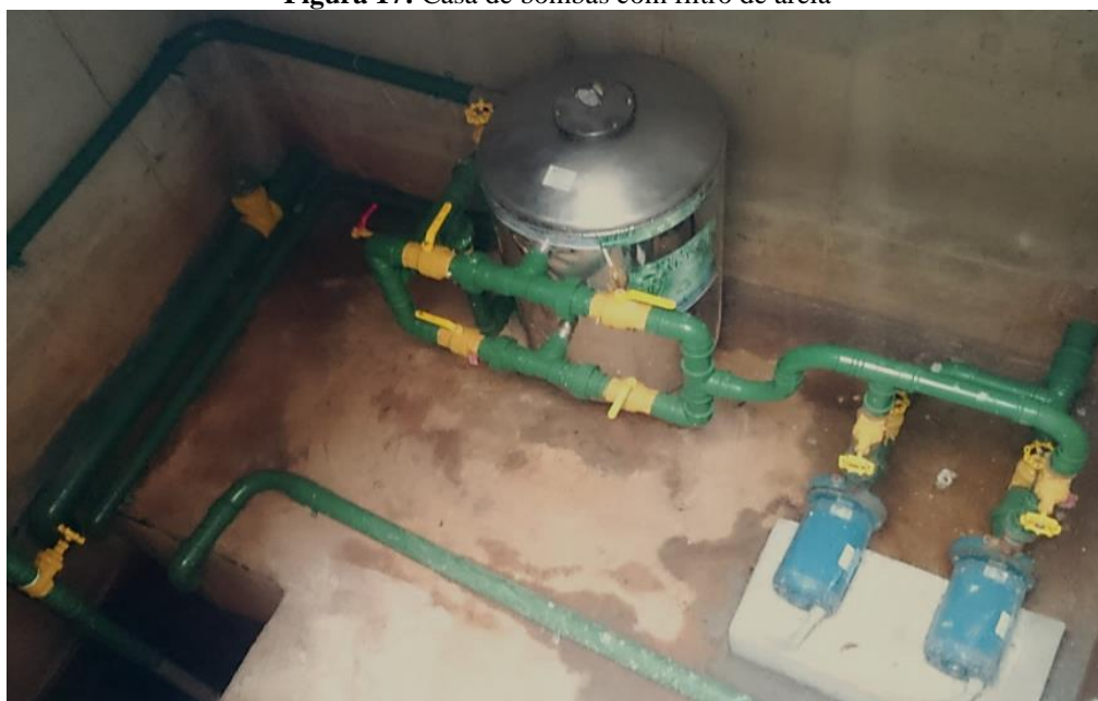
Figura 17: Casa de bombas com filtro de areia
