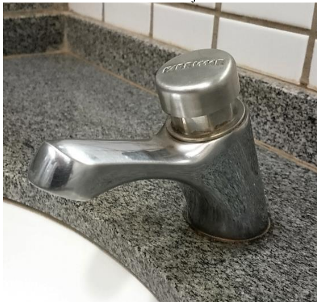
Figura 30: Torneira com fechamento automático e arejador utilizada nos lavatórios da edificação.
