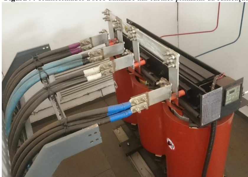
Figura 9: Transformador à seco utilizado nas cabines primárias da edificação
