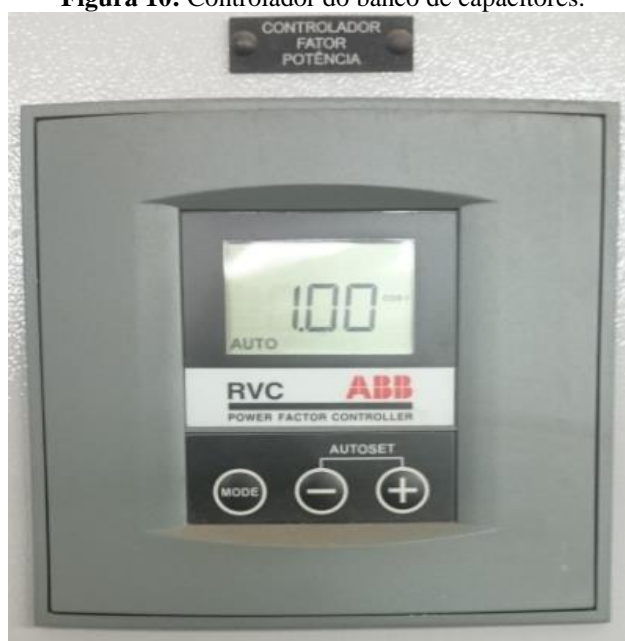
Figura 10: Controlador do banco de capacitores.
