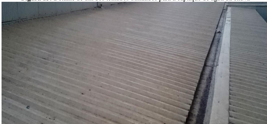
Figura 13: Detalhe de um dos telhados utilizados para a captação de água da chuva
